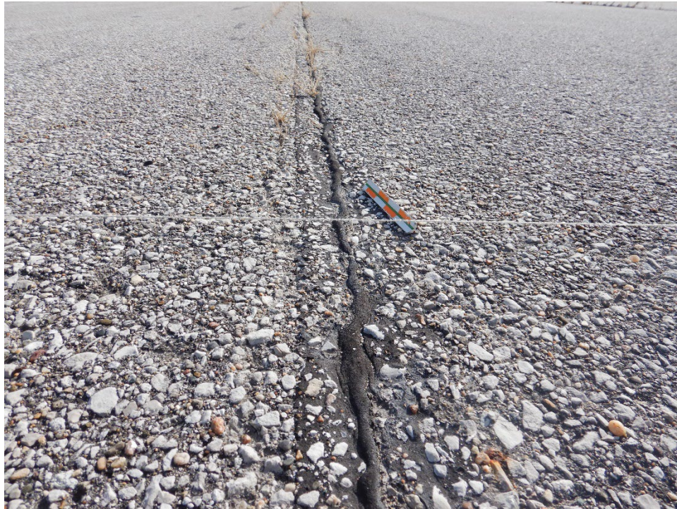
R13AL-03. Rutting (Sample Unit No. 03).
