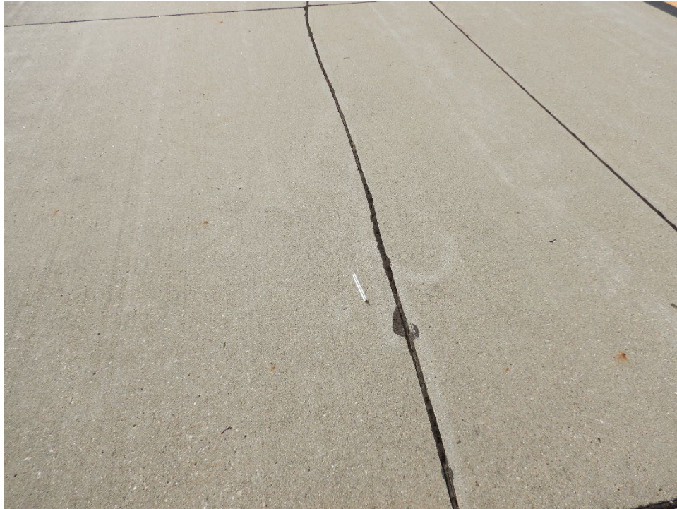
T12AN-01. LTD Cracking (Sample Unit No. 06).
