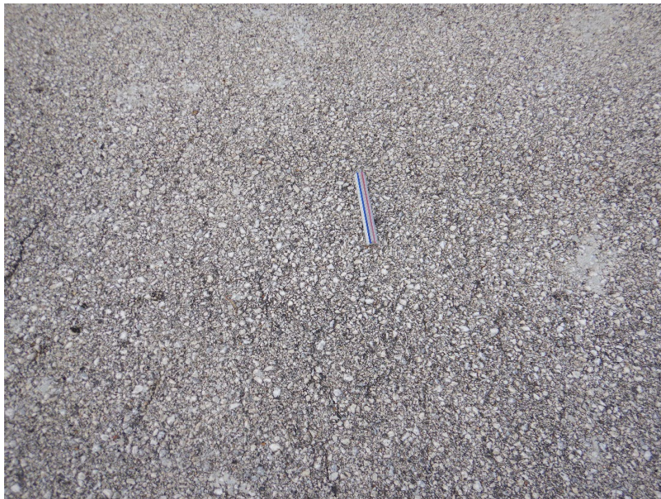
R16CT-03. Raveling (Sample Unit No. 44).
