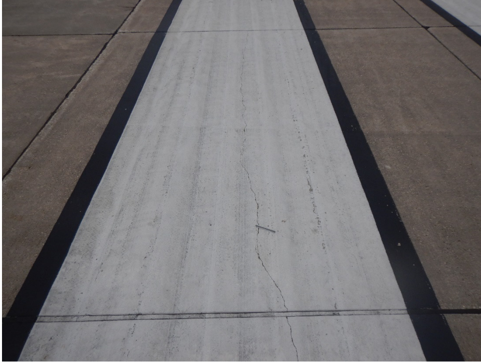
R11DE-03. LTD Cracking (Sample Unit No. 09).
