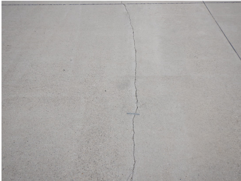
A01DE-05. LTD Cracking (Sample Unit No. 04).
