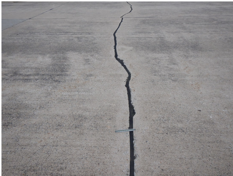
R11DE-02. LTD Cracking (Sample Unit No. 02).
