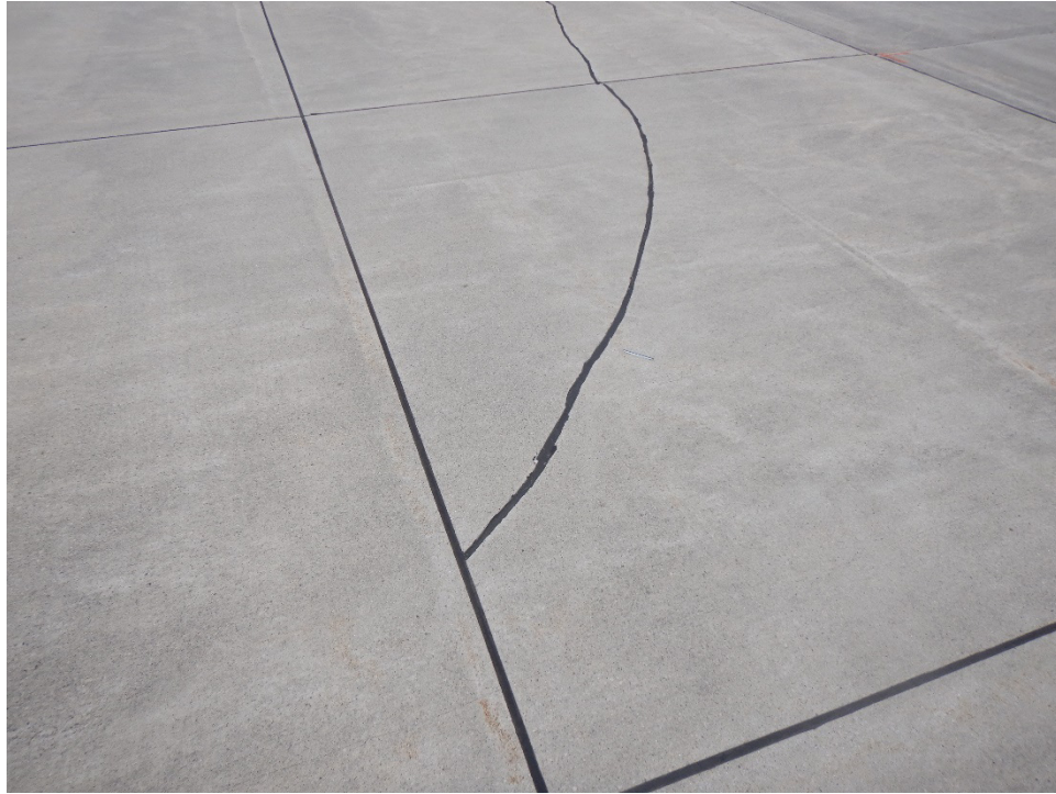
R11DE-04. LTD Cracking (Sample Unit No. 02).
