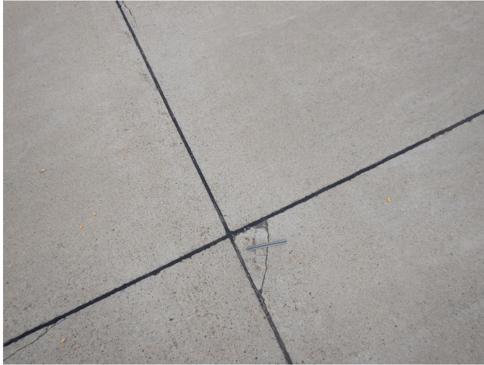
A01DE-05. Corner Spalling (Sample Unit No. 06).
