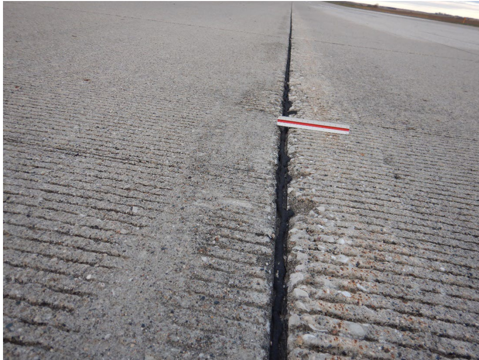
R12DN-01. Faulting (Sample Unit No. 22).
