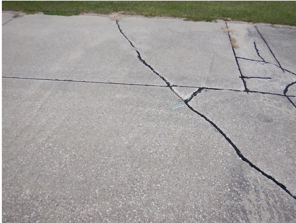
R12DN-04. LTD Cracking (Sample Unit No. 02).
