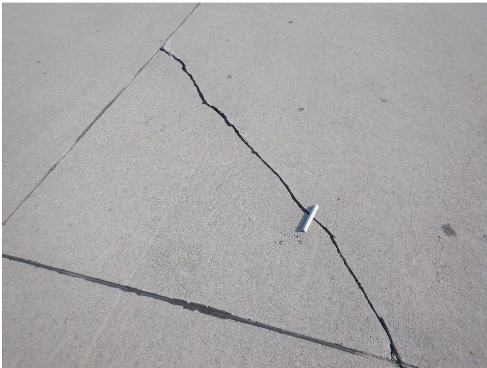
A01DN-02. Corner Break (Sample Unit No. 06).
