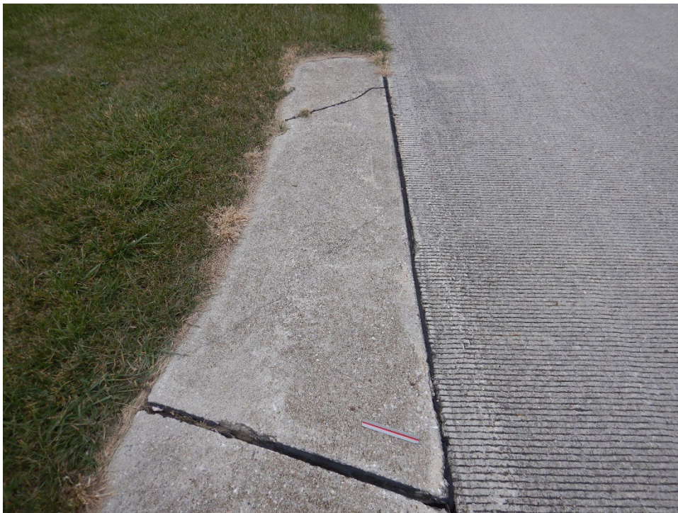
R12DN-06. LTD Cracking (Sample Unit No. 02).
