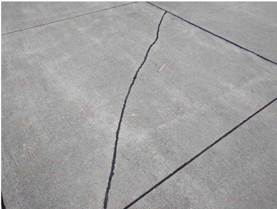
R12DN-05. LTD Cracking (Sample Unit No. 04).
