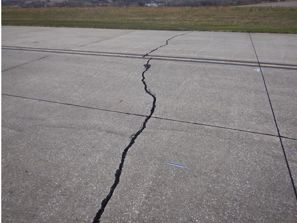
R12DN-03. LTD Cracking (Sample Unit No. 03).
