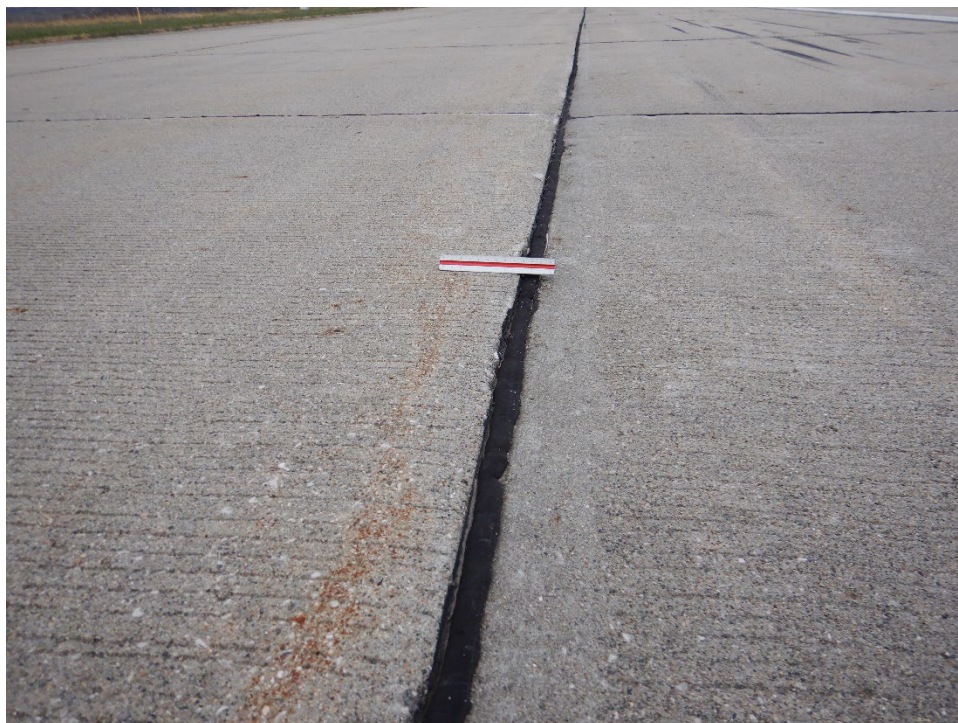
R12DN-02. Faulting (Sample Unit No. 02).
