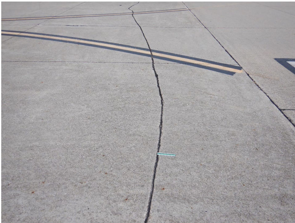
R12DN-07. LTD Cracking (Sample Unit No. 01).
