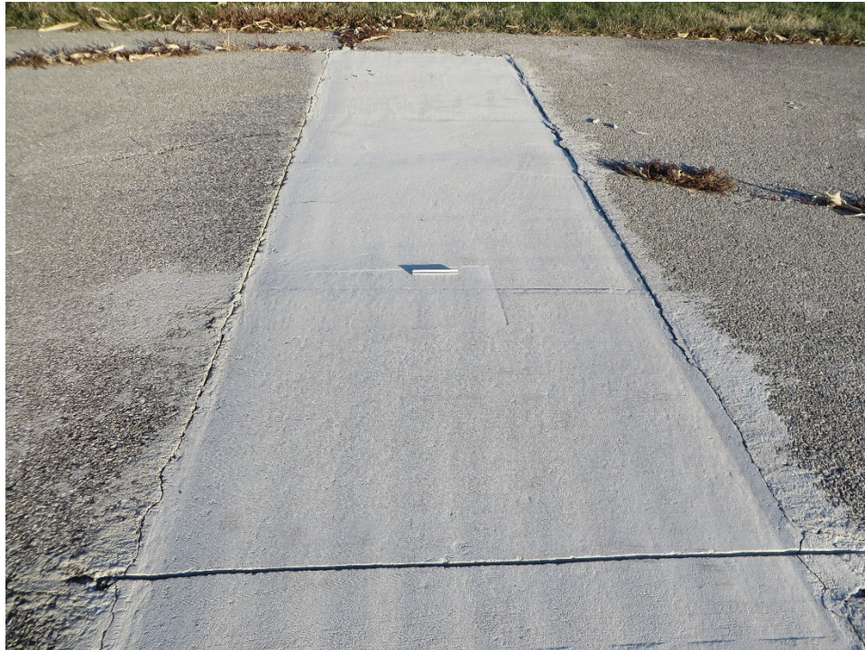
R17OS-01. Patching (Sample Unit No. 08).
